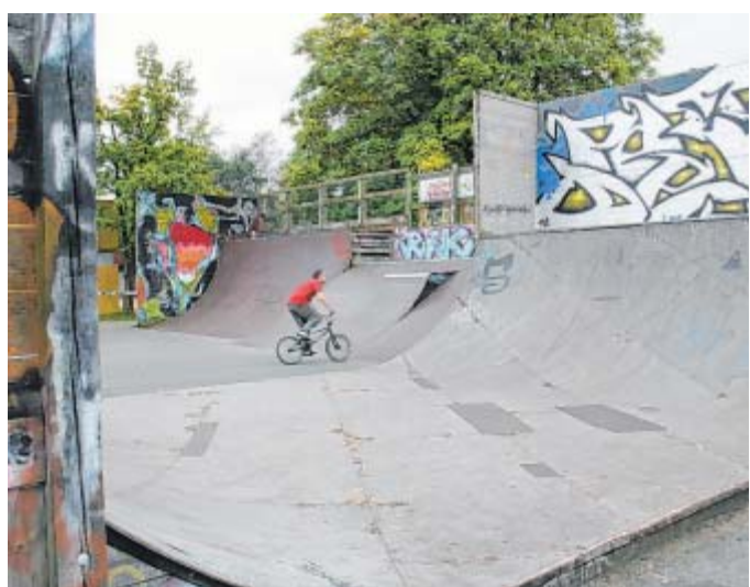
Bestandteil des Projekts „Ost-West-Grünzug“: Der marode Belag der Skaterbahn soll erneuert werden.
