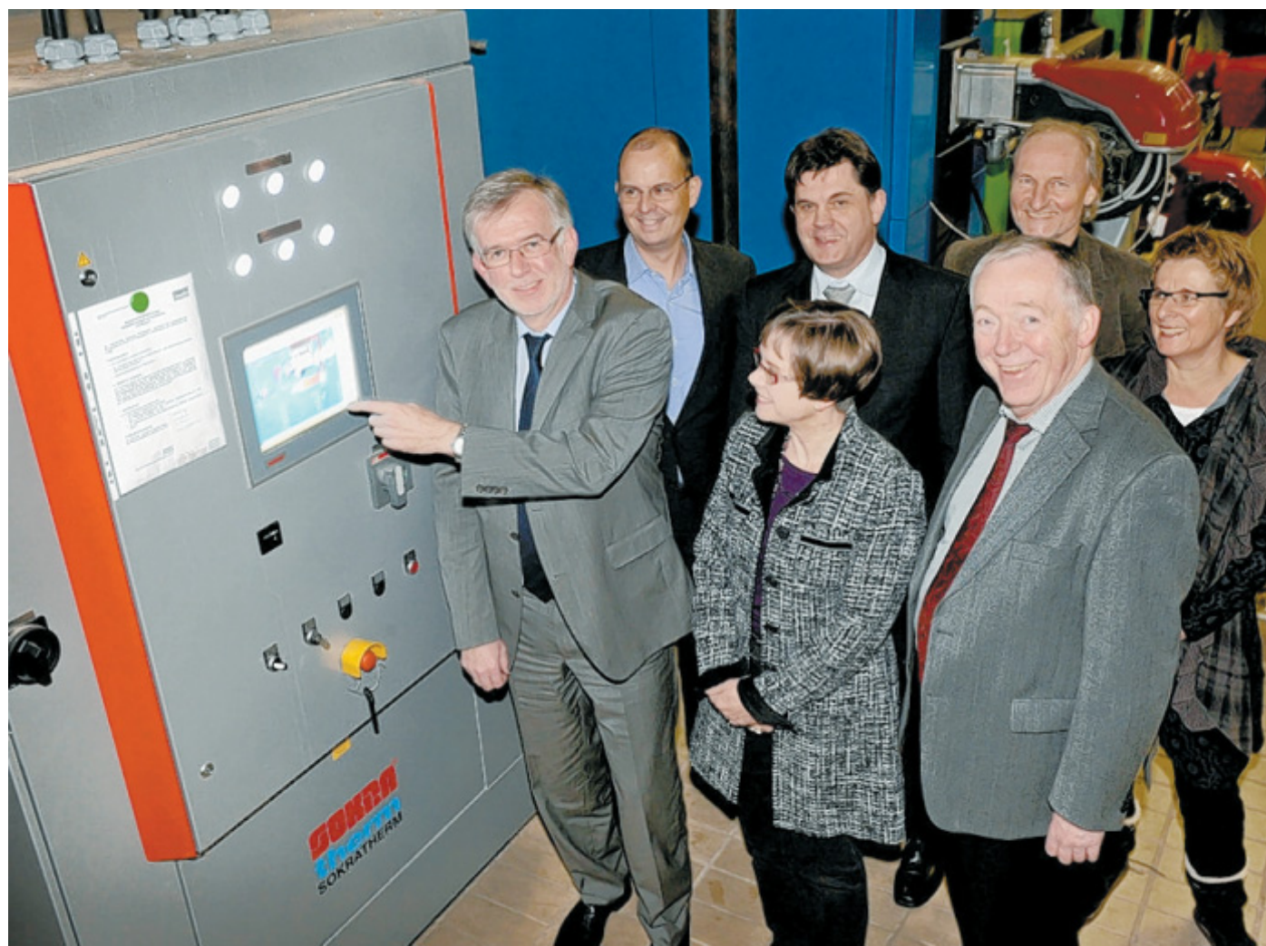
Energieeffizient: Die Stadtwerke -Geschäftsführer Friedhelm Rieke (l.) und Wolfgang Brinkmann (2.v.r) zeigen das Blockheizkraftwerk. Claudia Hoppe, Jürgen Ackermann (Berufskolleg Senne), Gregor Moss, Christiane Wauschkun (Rudolf-Rempel-Berufskolleg) und Stefan Jücker (ImmobilienServicebetrieb) (von rechts) sind sichtlich angetan. FOTO: SANDRA SANCHEZ
